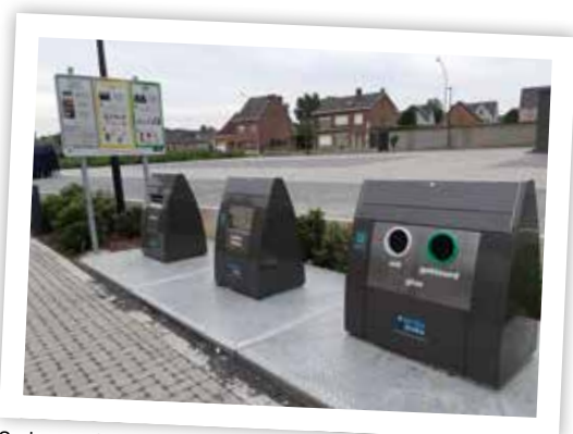
Ondergrondse afvalstraat Mazenzele
